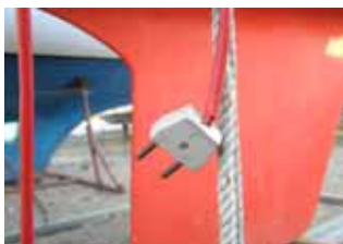
Under forårets gennemgang af havnen blev der konstateret en del ulovlige og dårligt vedligeholdte ledninger og stik.
